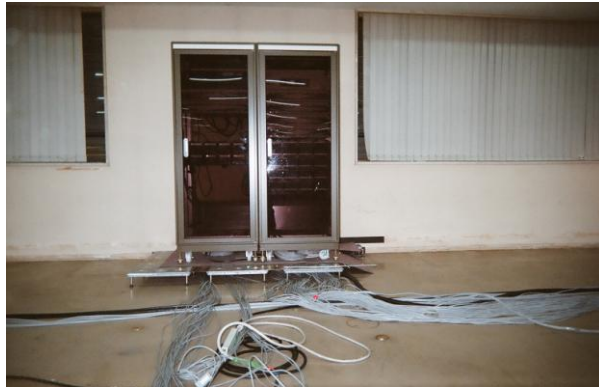
高さ10cm支柱式OAフロア撤去時の サーバー床下配線類
