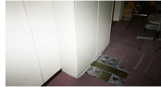
既存サーバー周辺フロア
