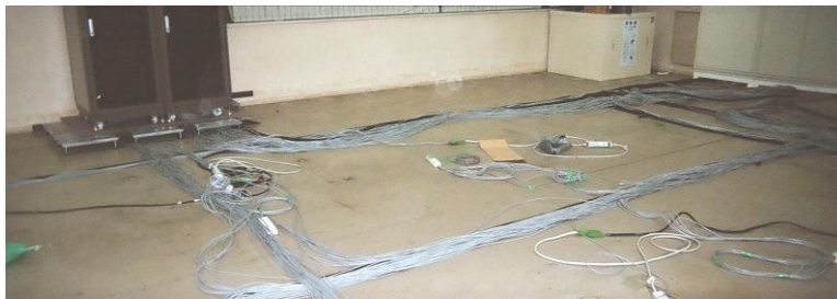
フロアコンセント・LAN配線はそのまま
